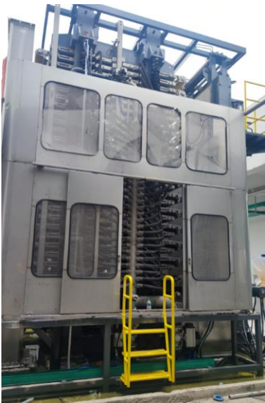
图 3 立式压滤机设备工程应用现场
